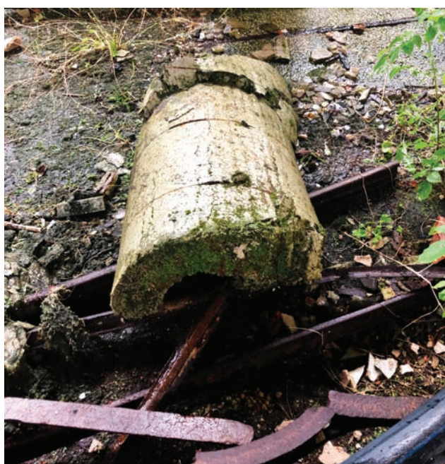
Figura 17. (b) Residuos incontrolados de material usado como calorifugado.
