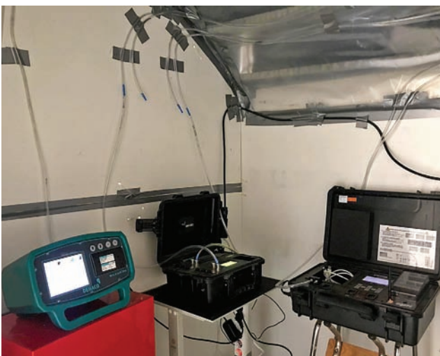
Figura 8. (b) Confinamiento a presión negativa.
