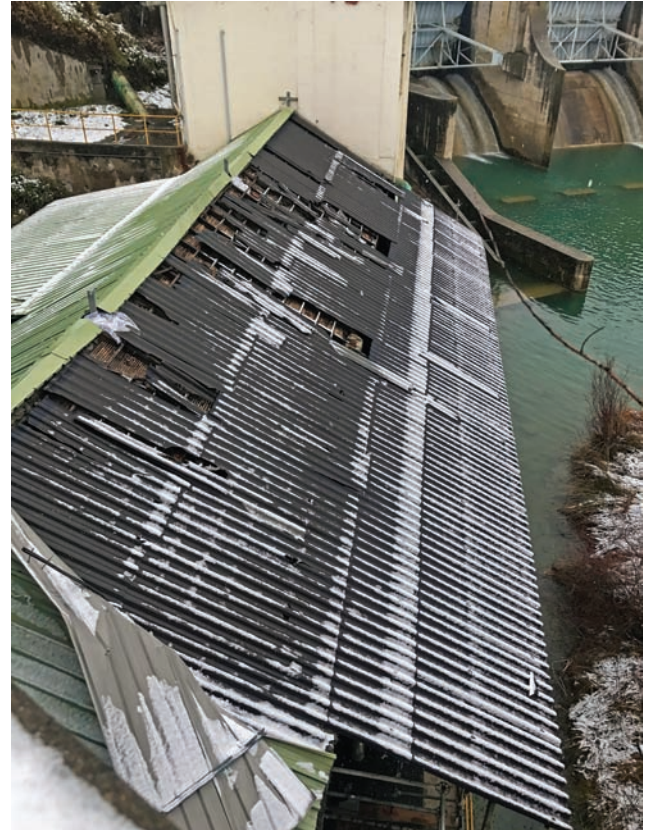
Figura 4. Cubierta de fibrocemento en mal estado.
