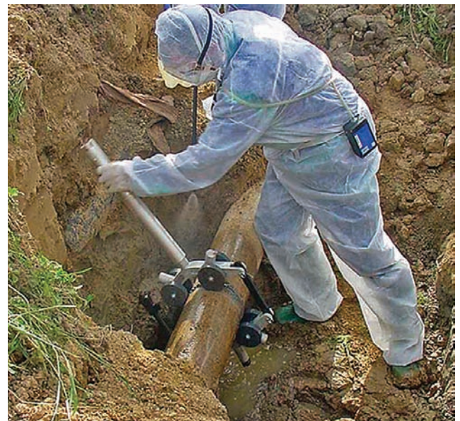
Figura 12. (b) Corte de tubería con aporte de agua para la retirada de materiales con amianto.
