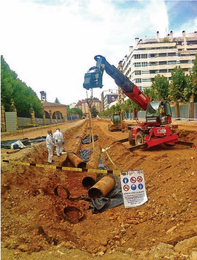
Figura 3. Señalización y acotamiento de la zona de trabajo en la sustitución de tuberías de amianto-cemento.
