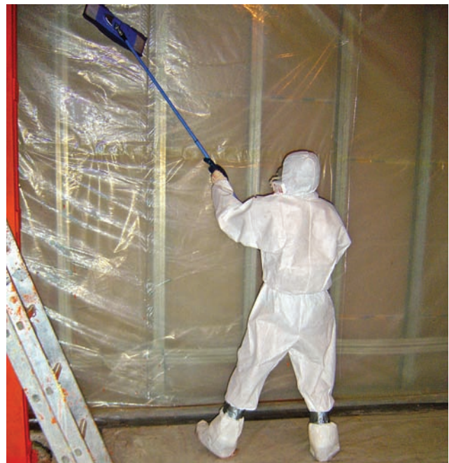
Figura 14. (b) Limpieza de superficies y plásticos mediante bayeta impregnada con agente fijador.
