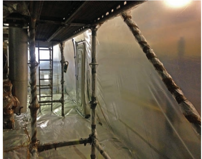
Figura 6. (b) Aislamiento de la zona de trabajo con un único punto de entrada y salida.
