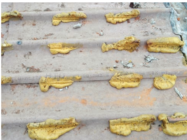
Figura 1 (a) Placas onduladas de fibrocemento fabricadas con amianto (AT).
